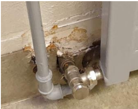
Mynd 4. Nærmynd af krana. Þar hafði verið smávægilegur leki líklega frá loka en einnig mátti sjá lélegan lokafrágang.
